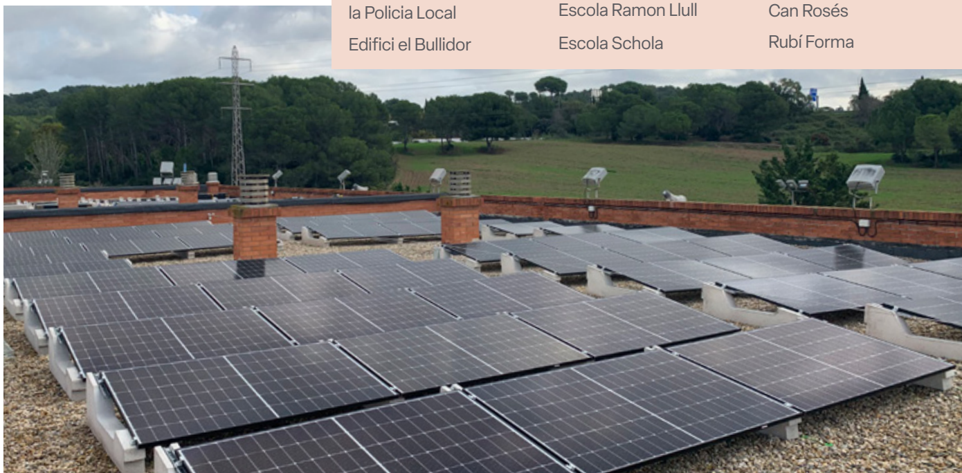
Nova instal·lació fotovoltaiqua de 48 kWp a l'Institut / Escola Teresa Altet.
